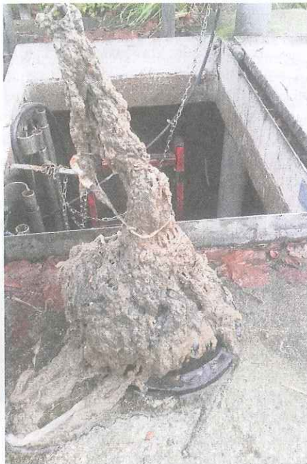
Bei solchen Verzopfungen (hier an einem Höhenstandsmesser) lässt sich erahnen, wie viel Müll jeden Tag durch die Nortorfer Toiletten gespült wird - und welche Probleme dieser Unrat bereitet.
